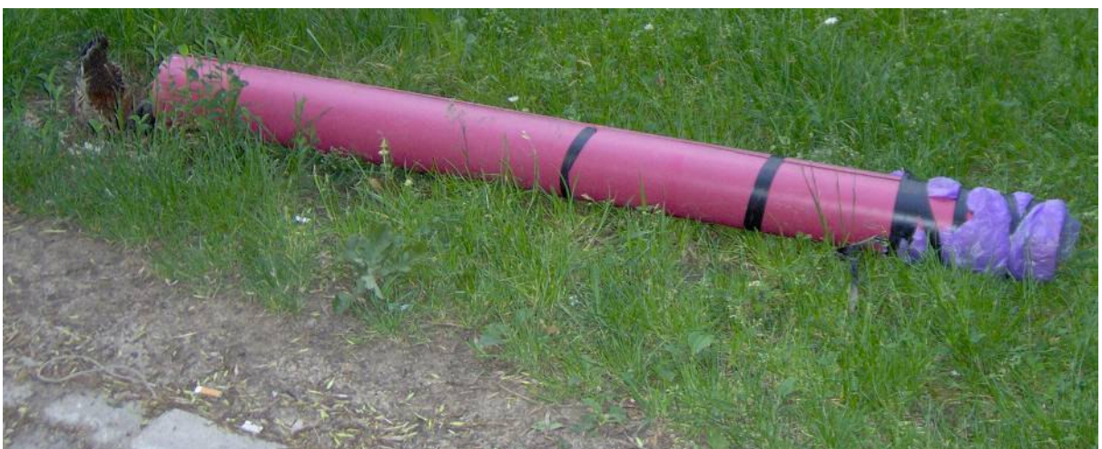
Slika 9. Ostatak drugog stuba sa instalacijama „zaštićenim“ plastičnom cevi
