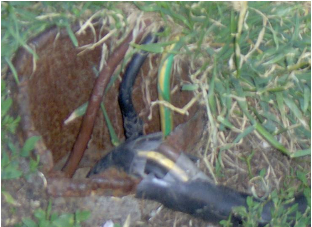
Slika 8. Ostatak stuba i instalacija nakon rušenja stuba
