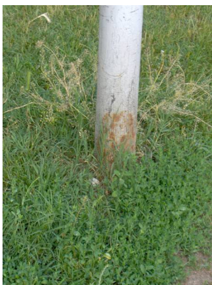
← Slika 6. Korozija stuba izazvana rastinjem
